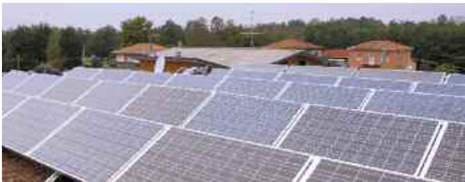
A SUPPORTO DELLE FONTI SPONTANEE DI ENERGIA SUL TETTO VI SONO PANNELLI SOLARI TERMICI ED ELETTRICI
